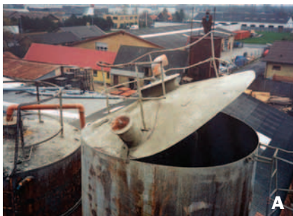
A. Silotak som fläkts upp när filter och avlastningsventil inte tillräckligt effektivt släppt igenom luftflödet.
